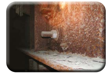
Rust og korrosion Kraftig indkapsling af rustfrit stål kan modstå korrosion.
